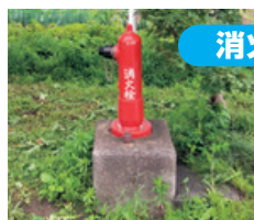
地上式消火栓
