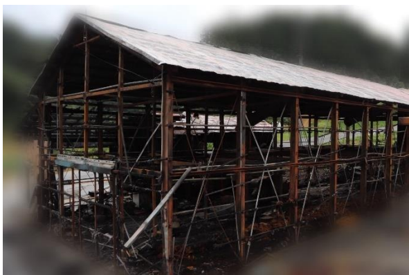
全焼した倉庫
