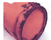
溶接部およびその周辺のさび
