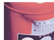
使用に耐えないキズ・変形
